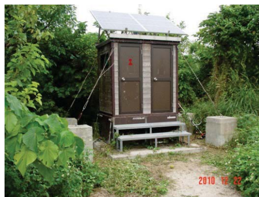
独立型太陽光発電システムを利用した バイオミカレット導入事例 出所:株式会社ミカサ ホームページ
